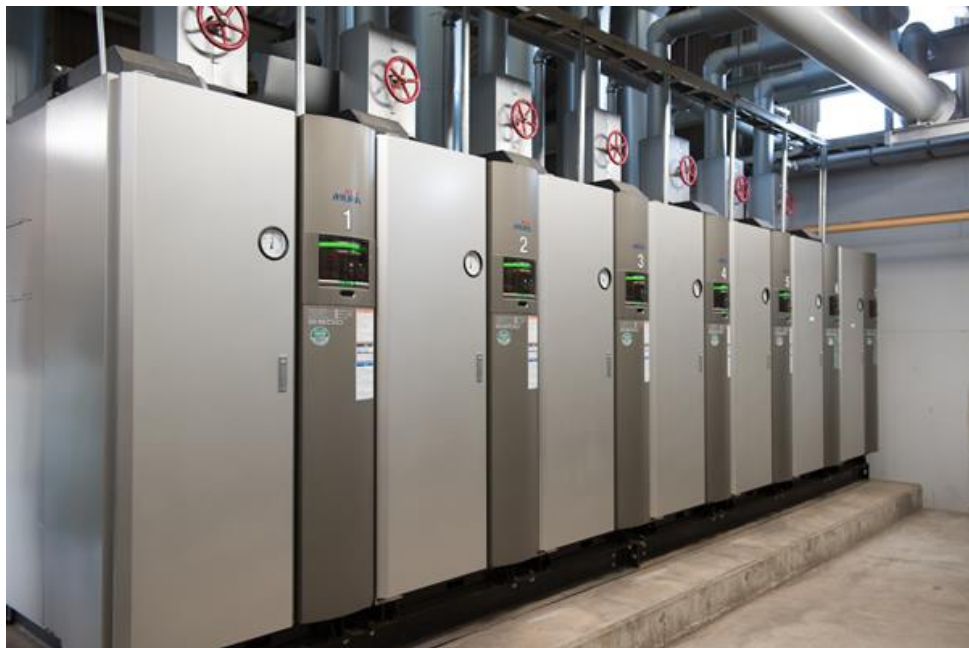
LNGによる蒸気製造(ボイラー)
