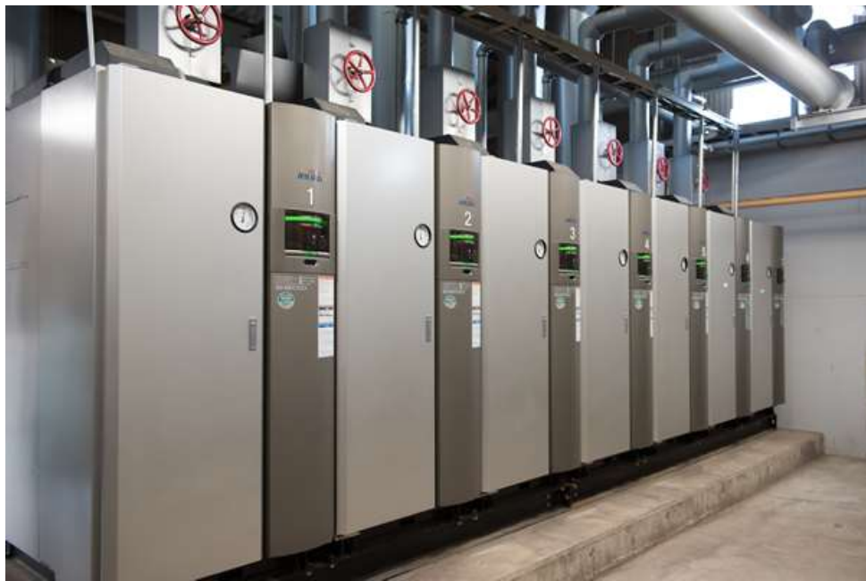
LNGによる蒸気製造(ボイラー)
