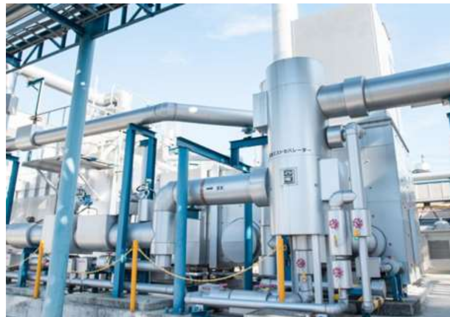
LNGによる自家発電 (コージェネレーションシステム)
