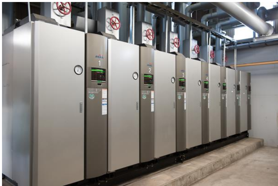
LNGによる蒸気製造
